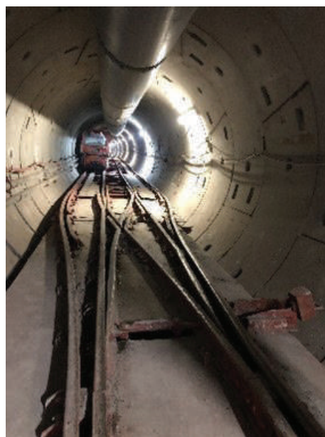
Cunicolo di sicurezza della galleria San Sebastiano (Chieti).
