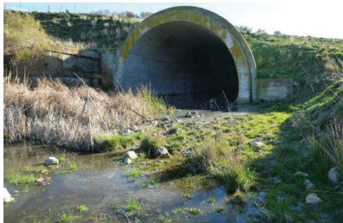
Imbocco galleria Paravola, Mistretta: stato dei luoghi dopo la sospensione dei lavori del 2002-2003 a seguito di eventi franosi.
